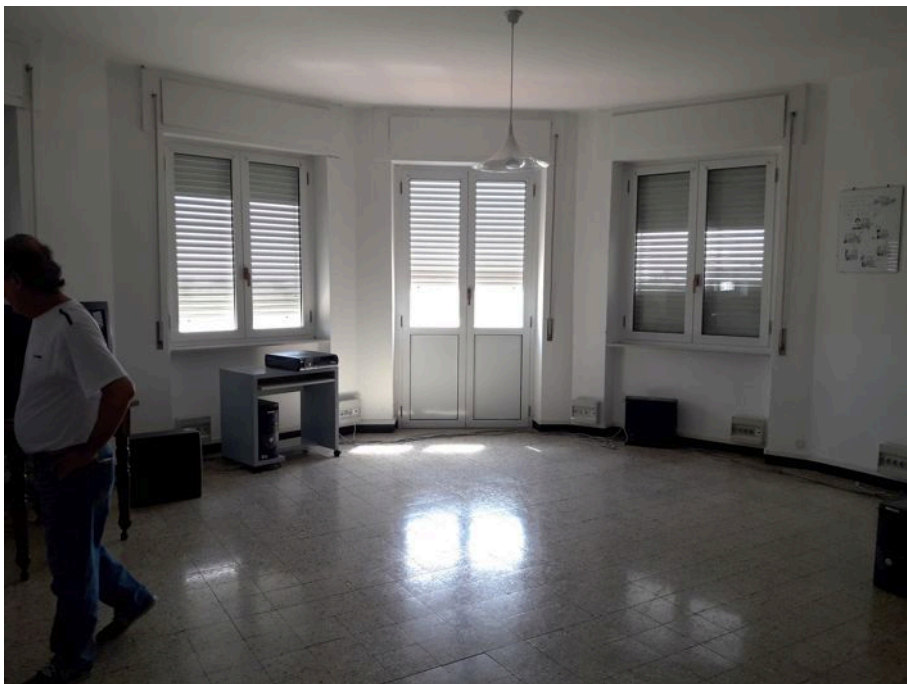
FOTO 48 – LOCALE LATO SUD PIANO SECONDO
